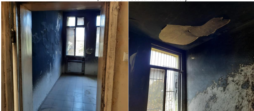
Обгорелите стени в изолятора
